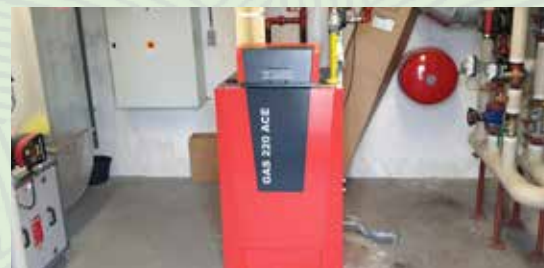
Energiezuinige cv ketel Entree Paviljoen
