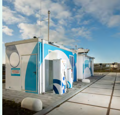
Waterstof-tankstation voor openbaar vervoer, Delfzijl.
