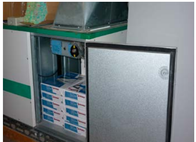
Figuur 2. De klimaatinstallatie van Museum Martena in Franeker bleek niet bij te dragen aan de reductie van risico's en is nu in gebruik als opslag
