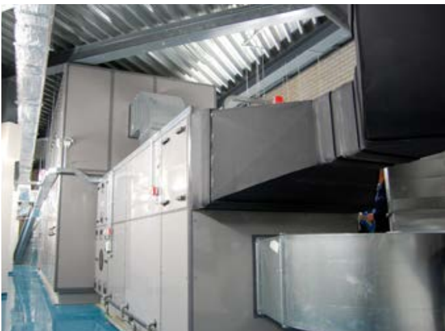
Figuur 1. Luchtbehandeling heeft nogal wat voeten in de aarde en brengt hoge kosten met zich mee. Is die inspanning gerechtvaardigd om de klimaatrisico's te reduceren?
