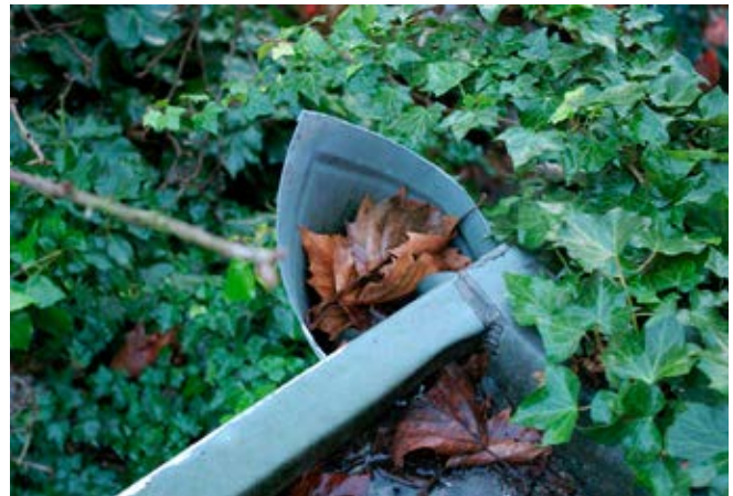
Figuur 53. Bij inspectie blijkt dat bladeren de regenwaterafvoer verstoppem
