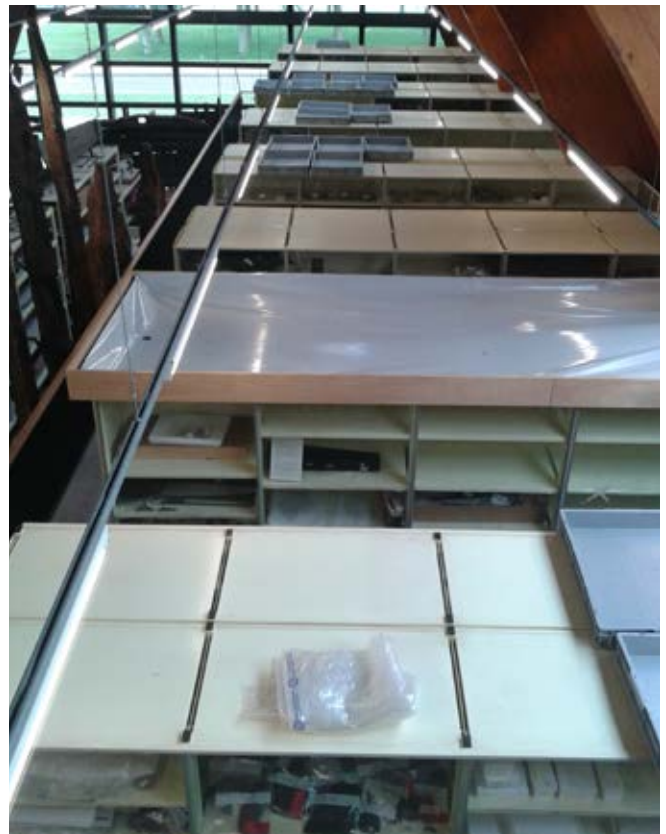
Figuur 55. Bescherming van de objecten tegen lekkage, door een water afvoerend dak op de kasten te plaatsen.
