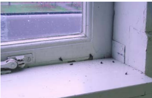
Figuur 81. Een van de beste plaatsen om binnendringers zoals vliegjes, muggen en wespen te ontdekken is de vensterbank
