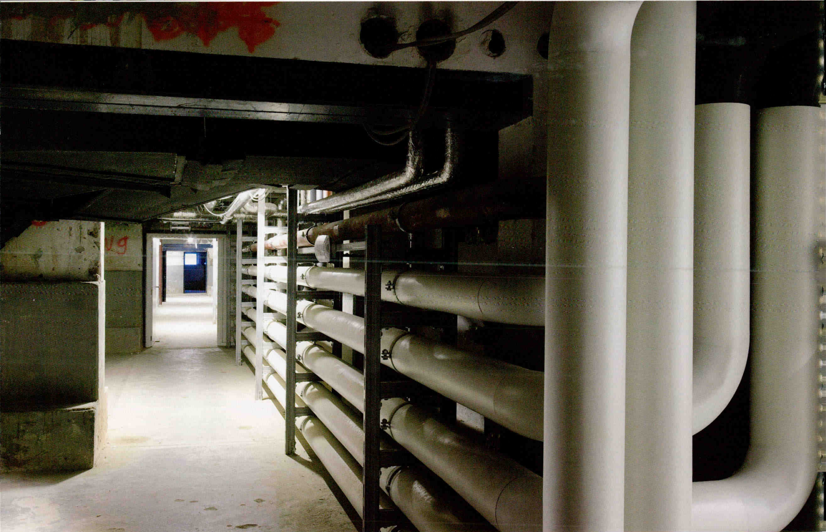
De erezaal met in de linkermuur twee doorgangen naar de nieuwbouw. onder Technische ruimte in de kelder van de oudbouw. The Hall of Honour with two entranceways in the left hall leading to the new extension. below Technical area in the basement of the original building.
