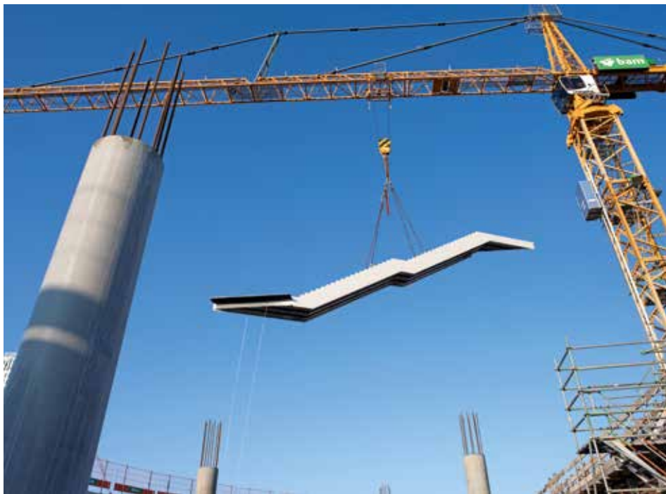
De eerste 18 meter lange trap wordt geplaatst in het atrium, foto Rob Glastra
