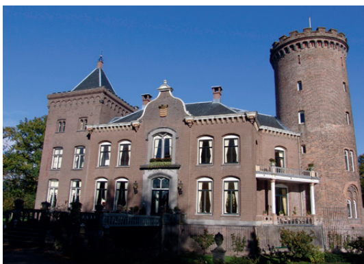
Het traptorentje van Kasteel Sterkenburg bij Utrecht was sterk vervallen en kan na restauratie weer jaren mee.
