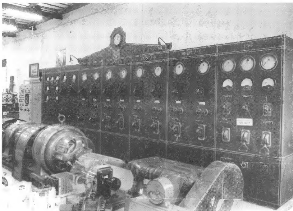
Elektro-zaal in het HEIM (foto: HEIM)
