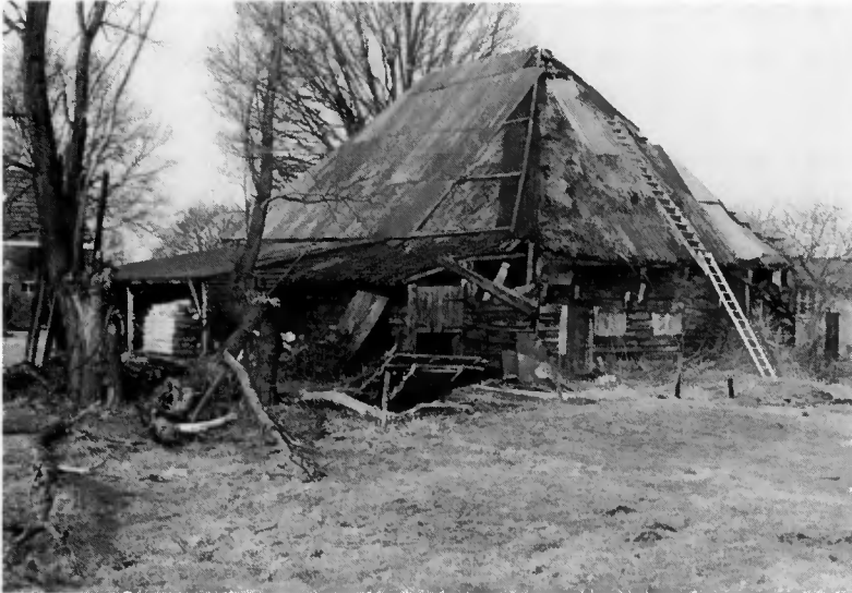
Prinsensbeek. Deze puntschuur is een 17e eeuwse bouwruk en vertegenwoordigt een ontwikkelingsstadium vóór de Vlaamse schuur. Opdrachtgever was Domeinen Oranje Nassau. (Foto: Gem. fotodienst Prinsensbeek)
